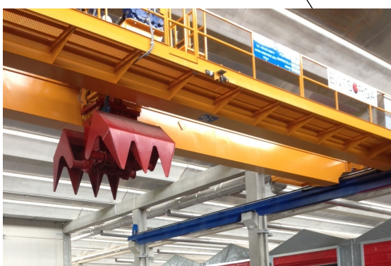
(1) CARROPONTE AUTOMATICO PER SPOSTARE IL MATERIALE
